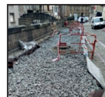
Structure stockante sous chaussée
